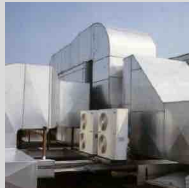
Klimatechnik auf Dach
