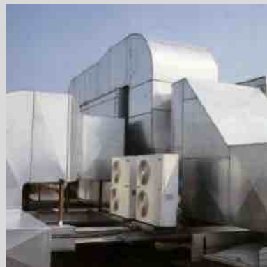
Klimatechnik auf Dach
